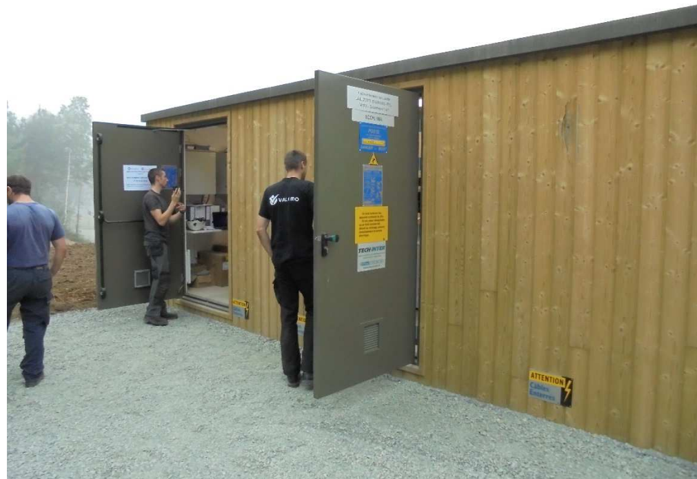
Photo 9 : Exemple de poste de livraison
